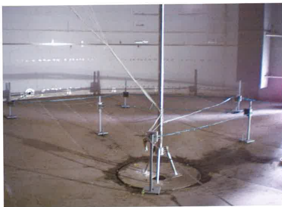
Fig. 14 - Sistema di monitoraggio costituito da tazze livellometriche, installato internamente al serbatoio.
